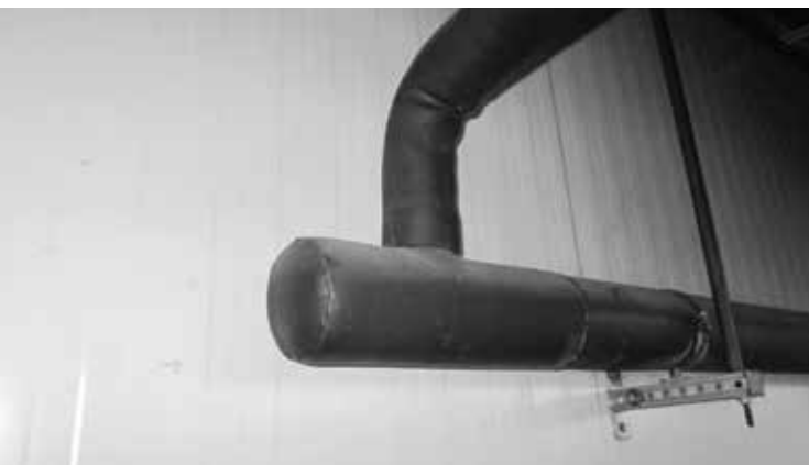
Figura 16. Isolamento dei tubi in buone condizioni.
