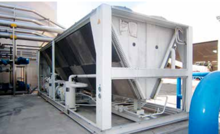
Figure 12. Impianto di raffreddamento.
