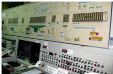
Figura 14. Pannello di controllo.
