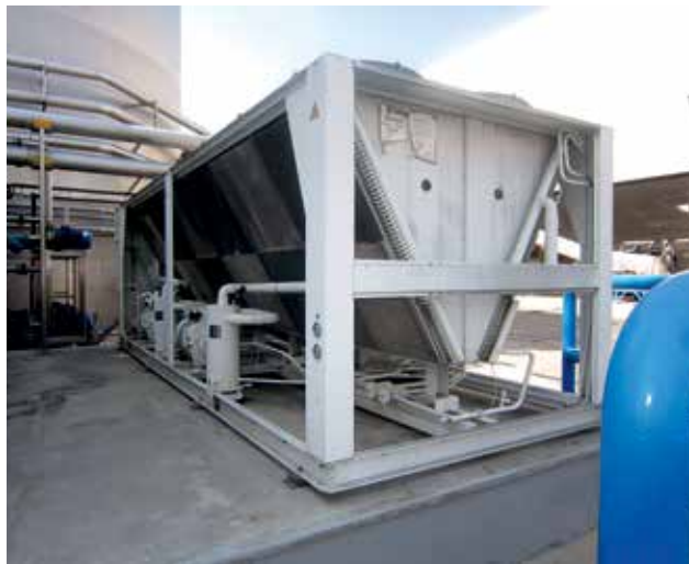
Figura 8. Impianto di raffreddamento.
